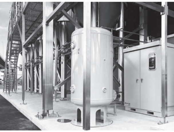
コンプレッサ外付けタイプの大型窒素ガス発生装置「NE IIシリーズ」の屋外設置(右側が装置)
